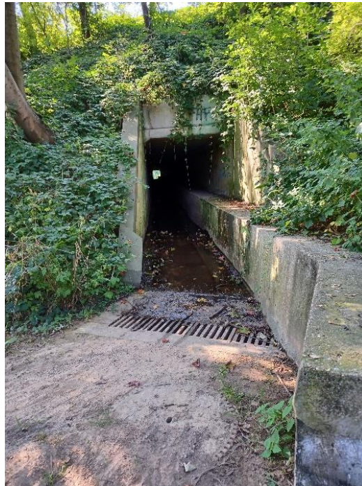
Figure 14 : Tunnel de collecte des eaux passant sous l'autoroute A4 et taques d'égout
